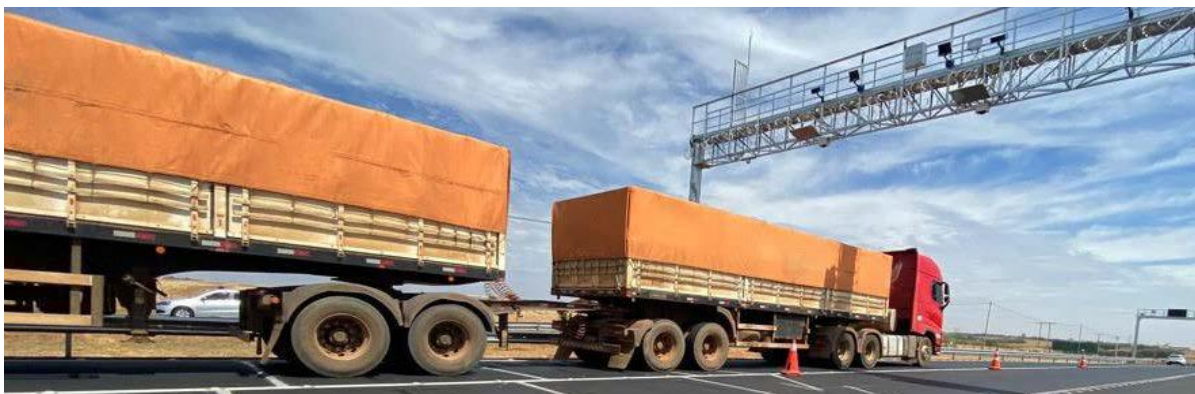
Figura 2 – Sistema de pesagem de veículos diretamente na rodovia – BRs 364 e 365
